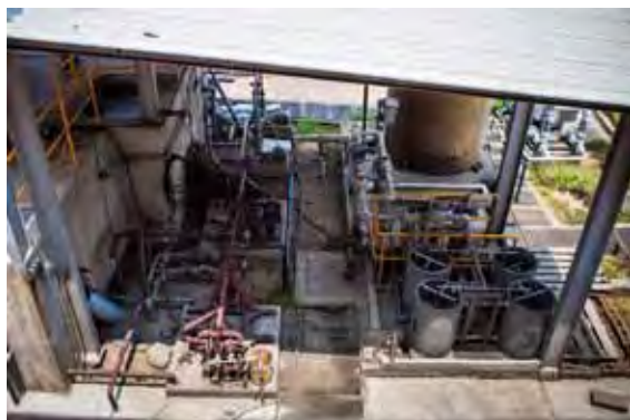
修護廠區第二廢水處理廠
