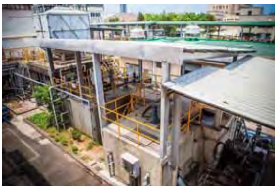
修護廠區第二廢水處理廠
